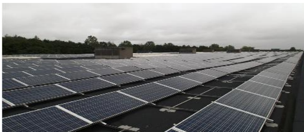
Figur 8 Top Danmarks PV-installation, Eget foto
